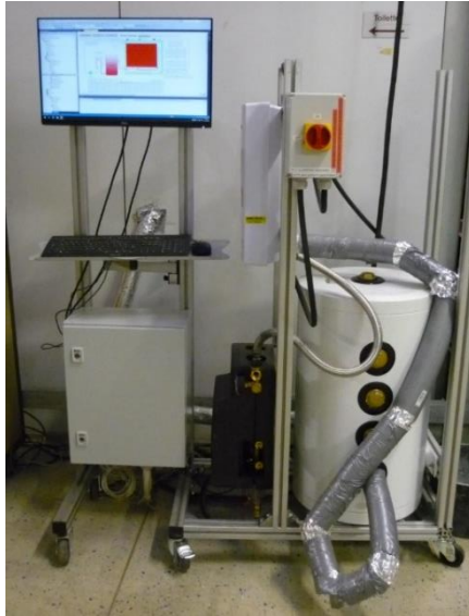
Bild 4: Durchlauferhitzer System Sunset (Modell PSM 80) zur Bereitstellung der Heizenergie mit Wärmeübergabestation für die Heizwasserversorgung der wärmeabgebenden Heizflächen.
